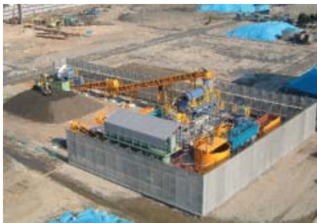
油脂汚染土壌洗浄装置
